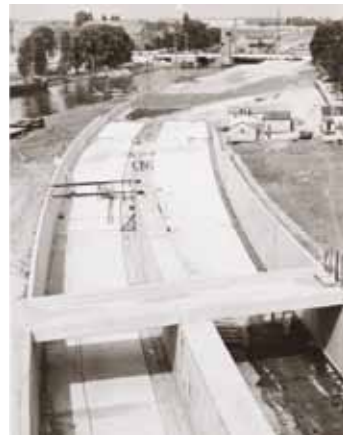
Constructie van de IJ-Tunnel, op de achtergrond de Gerben Wagenaarbrug (1966) Construction of the IJ Tunnel, in the background Gerben Wagenaarbrug (1966)
