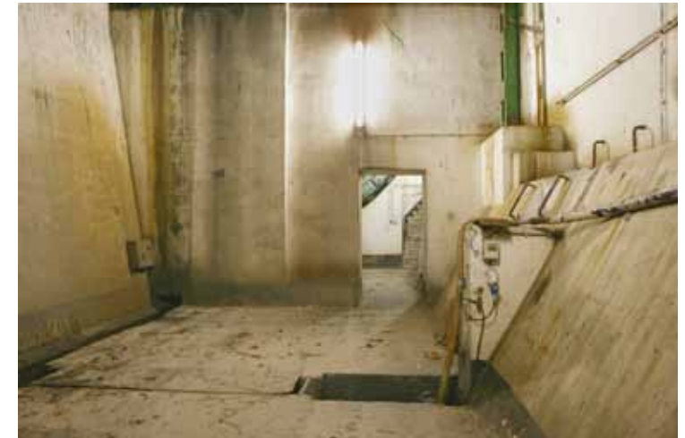
Interieur van de machinekamer van de Beltbrug (2006) Beltbrug engine room (2006)
