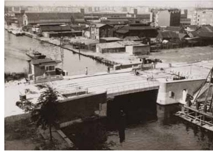
Bouw van de van Hallbrug, gezien in de richting van de Buyskade (1932) Construction of Van Hallbrug, view towards Buyskade (1932)
